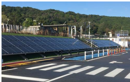
滋賀工場(性能確認試験走路「道夢道」) (2021年度設置)
