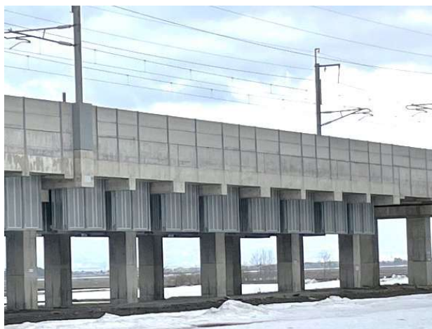
試験設置された吸音板
