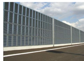
防音壁(吸音板)
