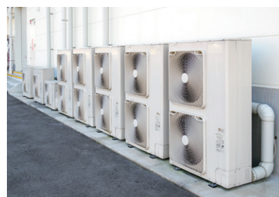
室外機まわり
