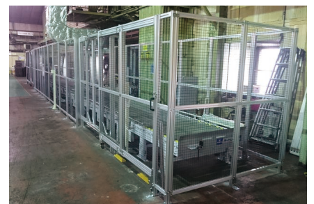
安全柵全景(スライド扉：閉じた状態)
