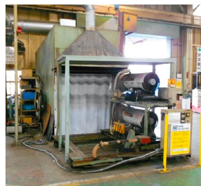
鋼管乾燥設備
