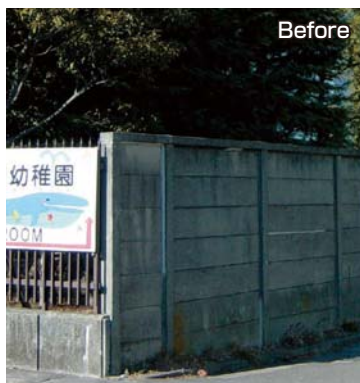
ブロック塀(改修前)
