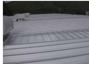
二重屋根と吸排気ファン
