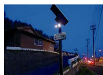
冠水対応ソーラー照明灯
