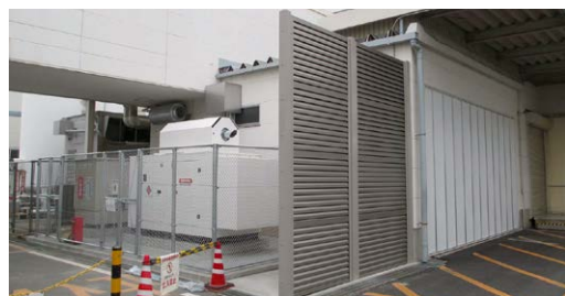
工場内騒音元の設備を囲う騒音対策
