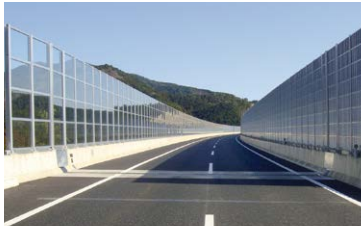
統一型防音壁+透明板
