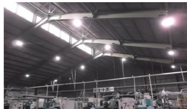
LED化が完了した工場天井照明
