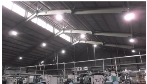
LED化が完了した工場天井照明
