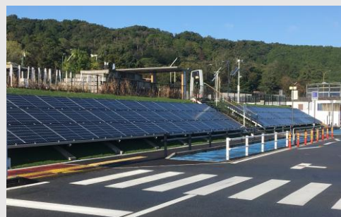
道夢道設置 太陽光発電システム
