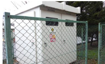
トッランナー変圧器を導入した受電設備
