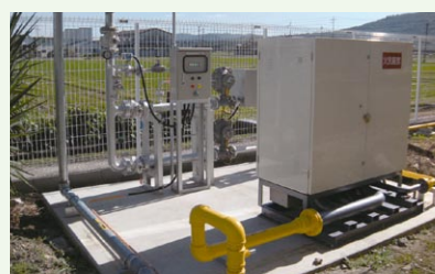
天然ガス受入設備(整圧機)
