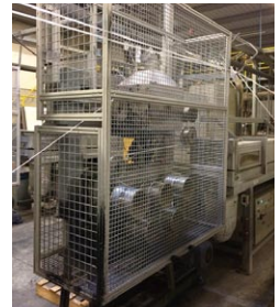
回転ロールの安全対策
