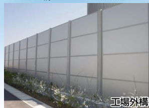
工場外構 めかくし塀「B型〈簡易遮音タイプ〉」
