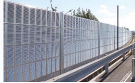
統一型防音壁
