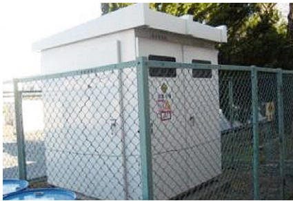
場内の変電所負荷率を見直し
