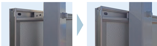
①パネル胴縁部分に取付金具を入れ柱の裏側からビスで固定
