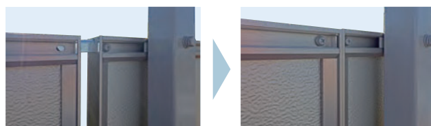
②パネル胴縁部分に接続金具を差し込み、隣のパネルと接続
